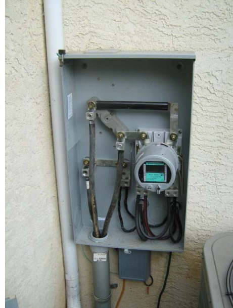
Open Meter Box
